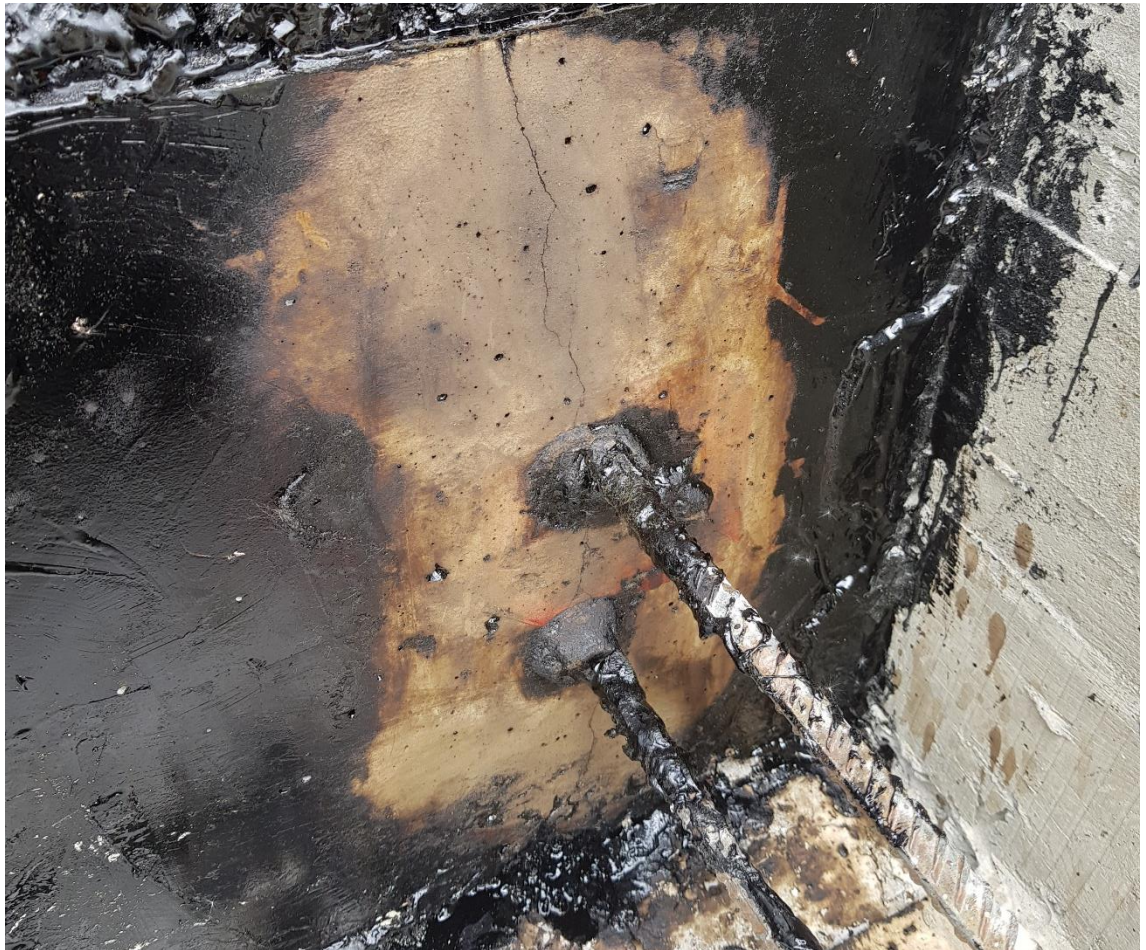
Фото №25 – Трещина на боковой поверхности фундаментной плиты
