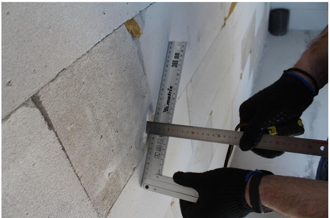
Фото №26 – Отбитость на стеновом блоке более 10 мм
