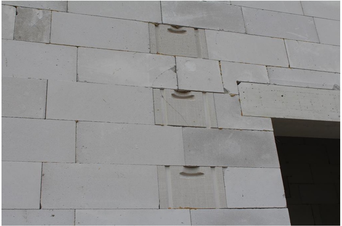
Фото №19 – Трещина по простенку
