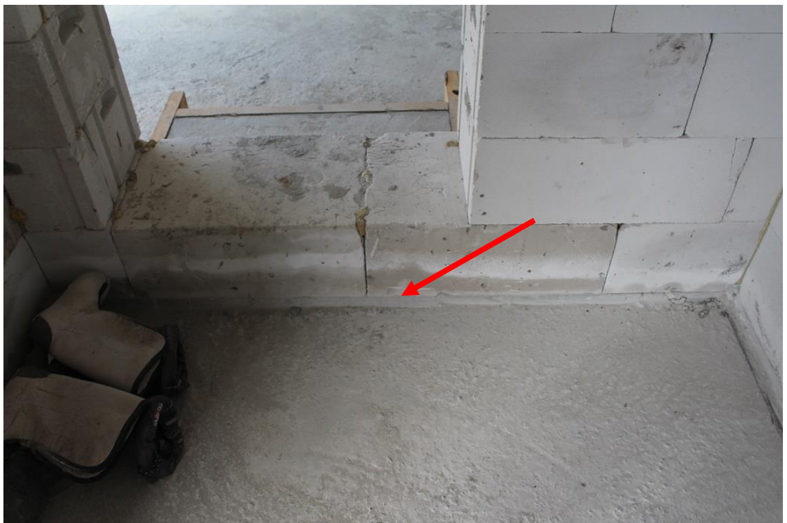
Фото №20 – Перекос рулонной гидроизоляции
